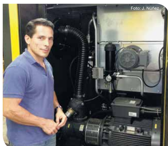
Jorge Chacón muestra el nuevo compresor instalado en la planta generadora de nitrógeno líquido.
